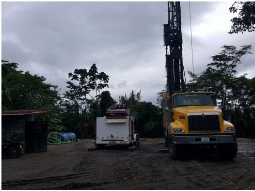
Máquina perforadora T3Wn 2 debidamente embancada y torre levantada. A la izquierda se muestra el equipo de recirculación de fluido de perforación.
